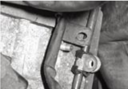
Klemme for hydraulisk rør, mot torpedoveggen
